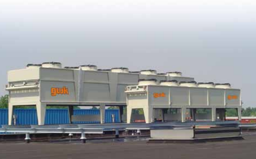
Zweikreis-Kühlanlage mit Kaltwassersätzen SKL und Energie sparender hermeticool-Technologie
