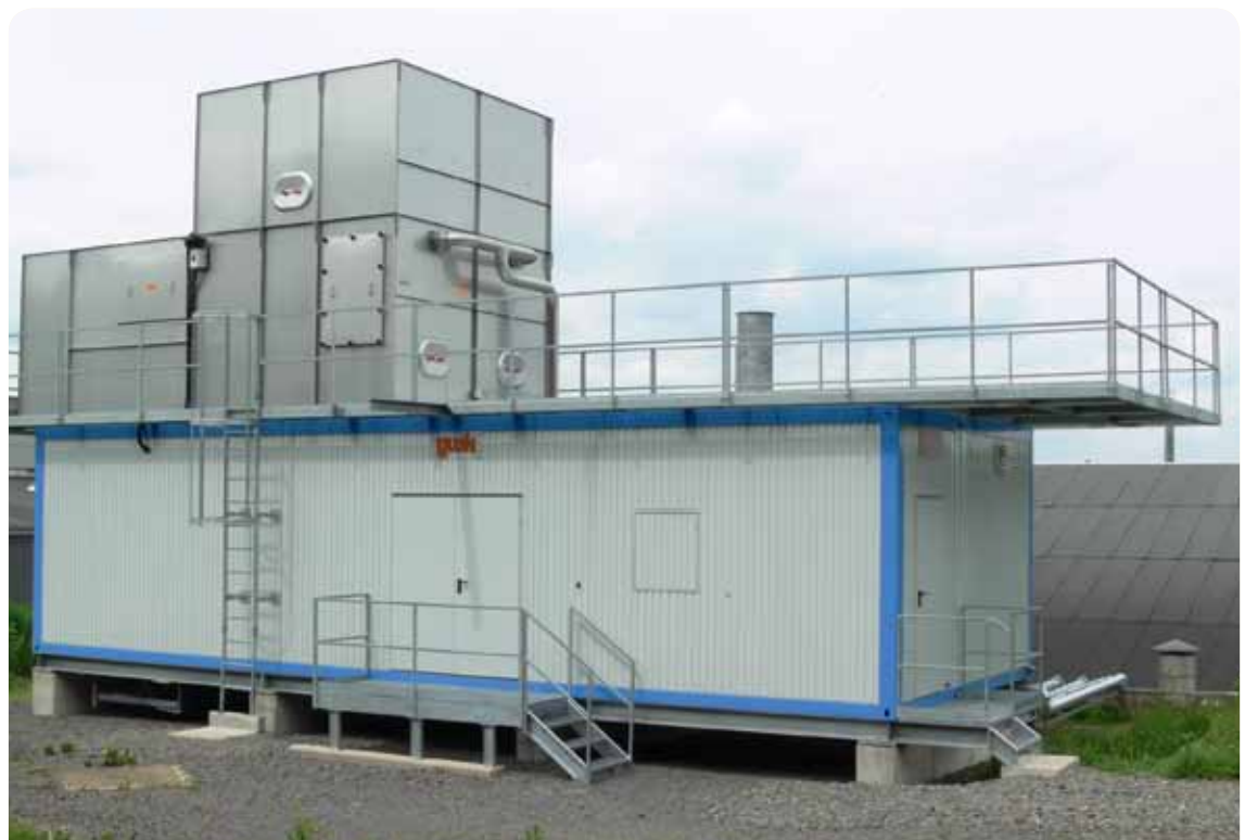
Erweiterbare Container-Kühlanlage mit Edelstahl-Kühltürmen
