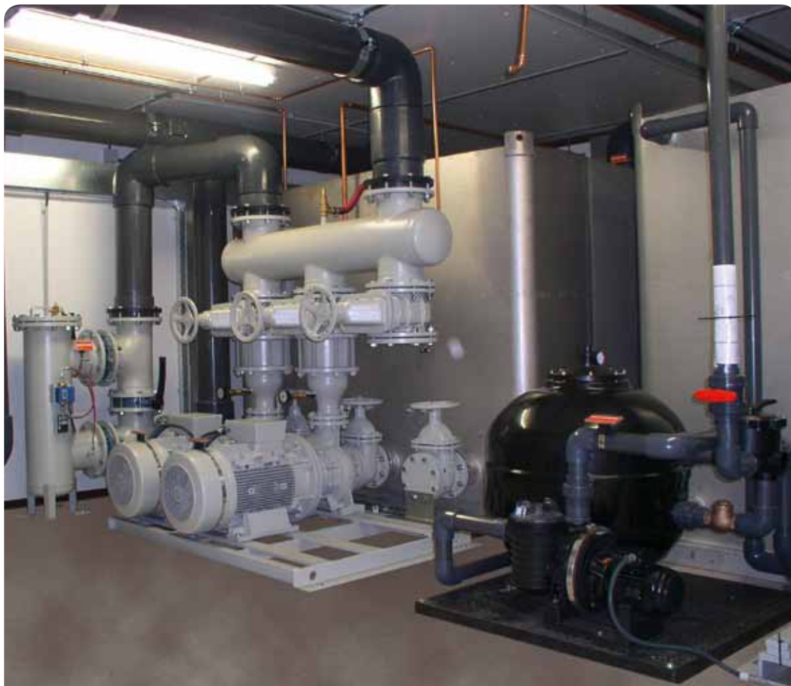
Pumpen und Behältergruppe im Container
