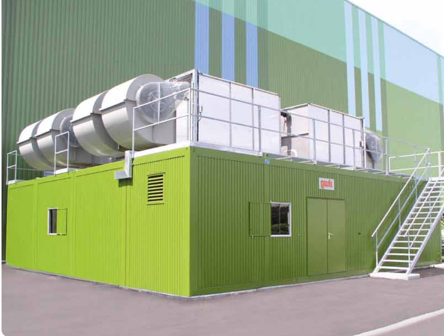
Container-Kühlanlage mit Edelstahl-Kühltürmen
