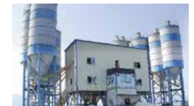
• 混凝土搅拌站
